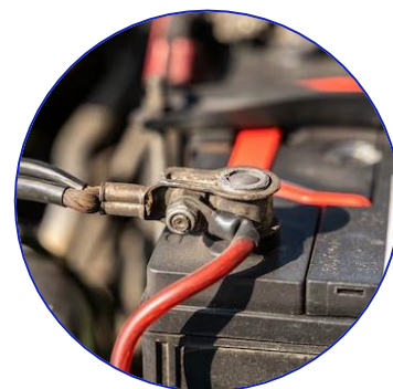
Terminales de baterías
